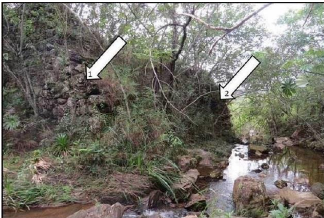
Figura 3: Ponto inicial do Canal dos Ingleses – barragem dupla em pedra bruta; local do rompimento devido a força das águas e falta de manutenção. Pontos de ruptura: Coordenadas: Seta 1 – 21° 08' 21,6" S – 44° 17' 19,7" O; Seta 2 – 21° 08' 22,0" S – 44° 17' 19,5" O. Altitude: 1.042,00 m. Foto: Luciano Oliveira em 29/03/2016.
