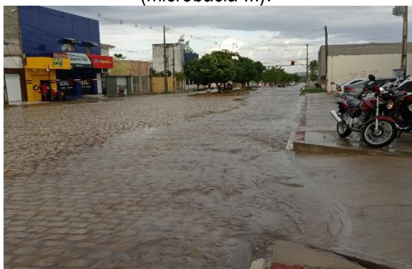
Figura 14: Alagamento na Av. Monsenhor Samuel da Fonseca após chuva torrencial (microbacia III).
