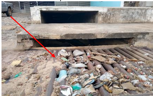
Figura 20: Lixo carreado através da água pluvial para bueiro.
