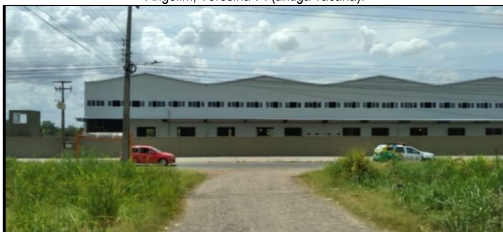
Figura 3: Fotografia da construção e instalação dos galpões da empresa J&T Express - SC , bairro Angelim, Teresina-PI (antiga vacaria).
