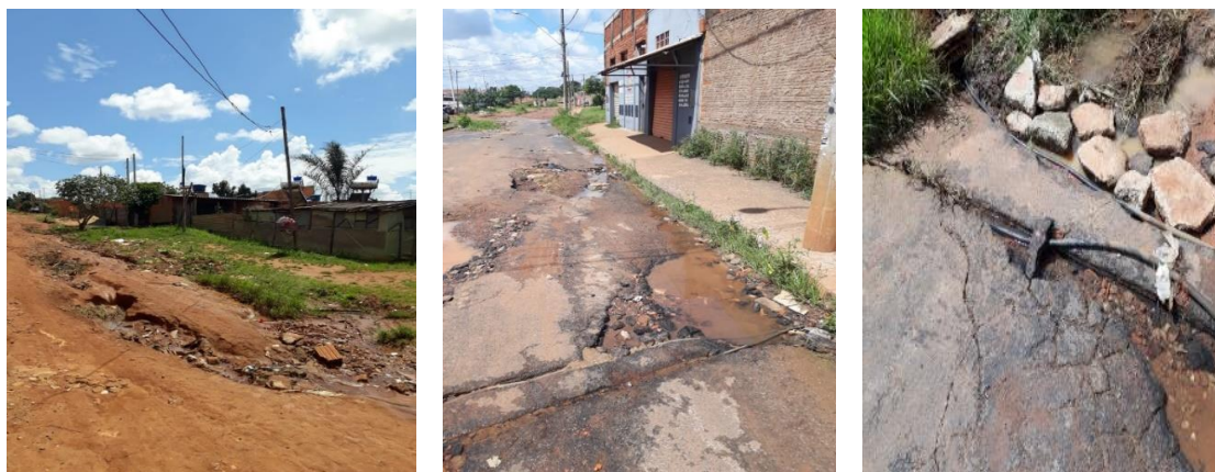
Figura 8: Assentamento do Glória: Problemas na rede de abastecimento de água – 2020.
