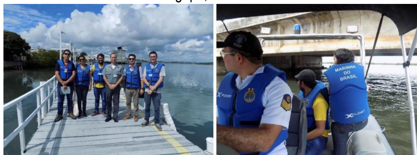
Figura 7: Campo realizado em parceria com Capitania dos Portos para avaliação da estrutura da Ponte de Igapó, Natal/RN.
