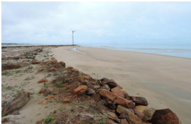
Figura 3: Blocos de concreto ao longo da faixa de praia e ao redor da base da eólica
