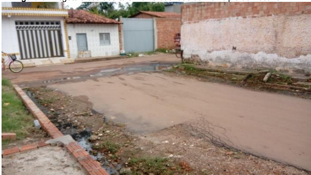
Figura 5 - Esgoto a céu aberto em uma das ruas do município de Rosário - MA.
