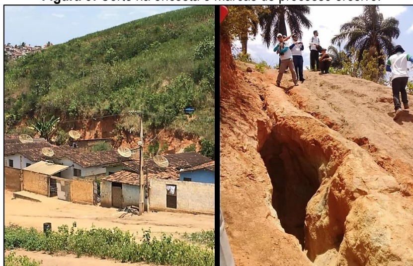
Figura 3: Corte na encosta e marcas de processo erosivo.
