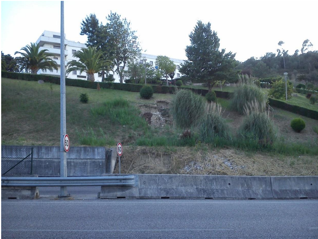
Figura 13. Vertente Hotel D. Luís com deslizamento.
